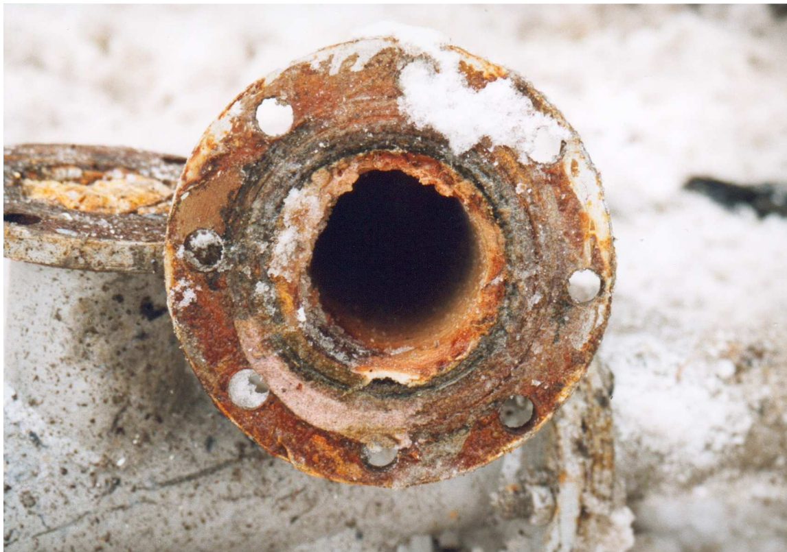
Bild oben: Rohr DN 100 aus einem Kunststoffwerk mit Kunststoffablagerungen - vor der Reinigung.
